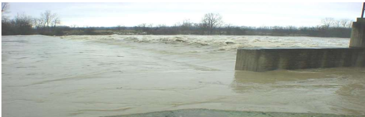
Le acque limacciose dell'Orba scavalcano anche la nuova diga. L'antica diga di Pochettino fu spazzata via dalla furia dell'alluvione del 1977
